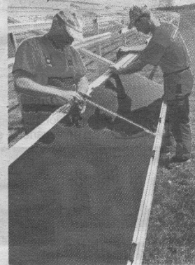
Les panneaux solaires séduisent toujours davantage. keystone
